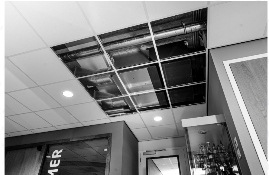
Luchtbehandelingskast met gesloten plenum boven het systeemplafond (voor de foto opengewerkt)
